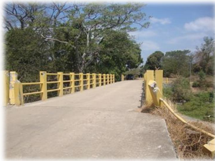
Fotografías No 43-45 Borda de protección dañada con las tormentas tropicales
